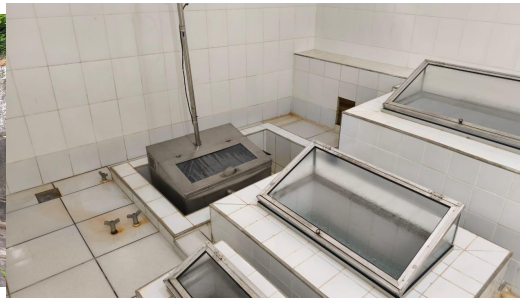
Captação da Fonte
